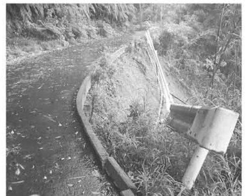
2010年6月の被災状況（口永良部島）
