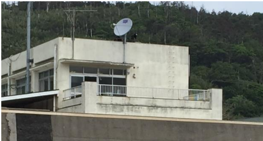
口永良部出張所に設置した衛星ブロードバンド パラボラアンテナ
