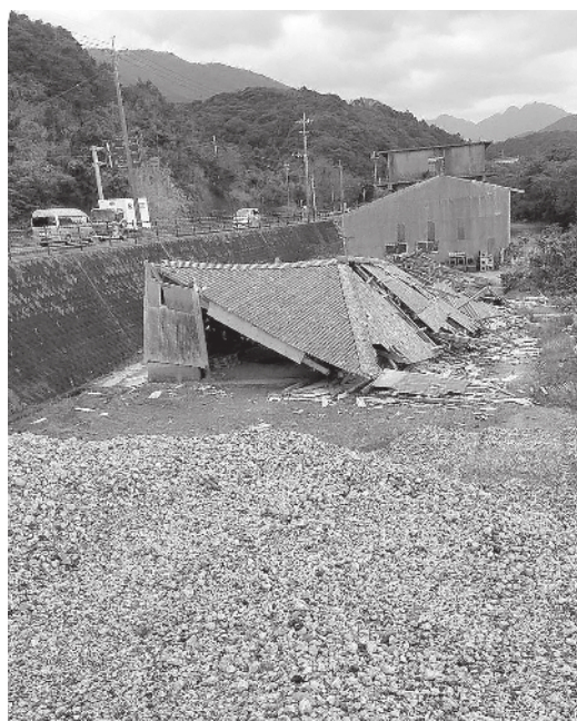
台風被害で倒壊した大型の倉庫
