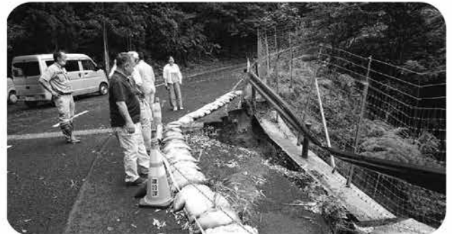
水の流れて崩落した南部林道
