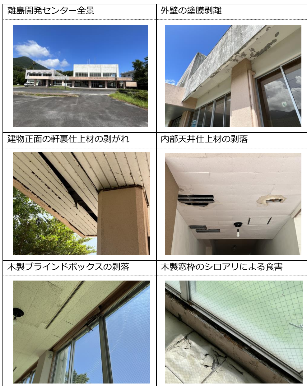
図 2-1 屋久島離島開発総合センターの劣化状況
