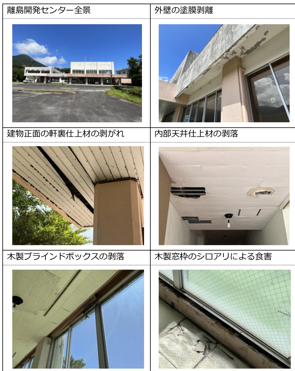
図 2-1-1 屋久島離島開発総合センターの劣化状況
