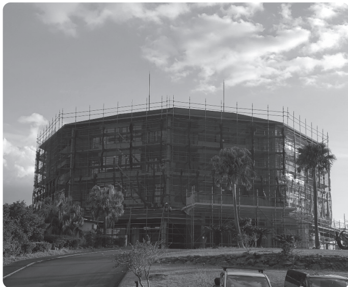
4月下旬にリニューアルオープンに向け工事中の samana hotel 屋久島
