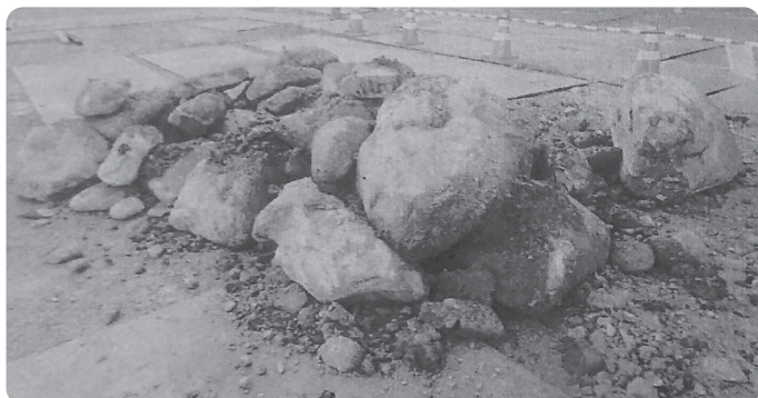
廃棄物処理施設建設中の地中にあった障害物
