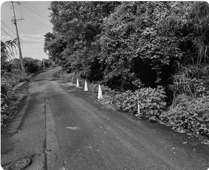
ガードレール設置が必要な道路
